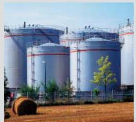
Champs d'application: Batterie de silo
